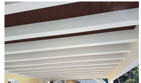
In traditioneller Kunst des Zimmerer-Handwerks, werden die Verbindungen frei von sichtbaren Metallverbindern, hier mit Schwalbenschwanz-Verbindung ausgeführt.
