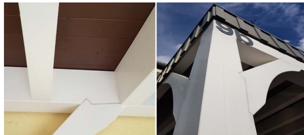
Frei von sichtbaren Metallverbindern werden die Verbindungen - hier mit doppeltem Versen-Versatz ausgeführt. Die geschwungenen Kopfbänder, Pfosten und Deckenbalken sind aus geprüfem und verleimten Qualitäts-Fichten-Massivholz. Dieses sieht nicht nur ästhetisch aus, sondern hat auch eine enorme Tragfähigkeit
